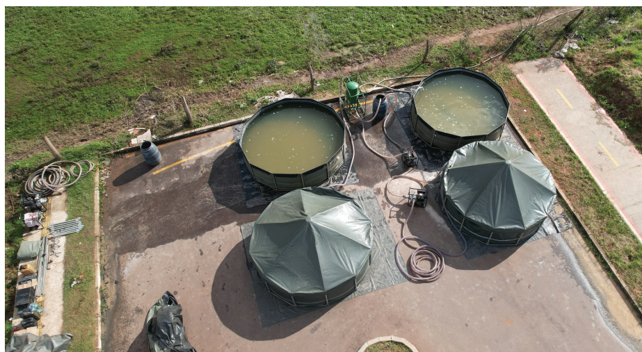
Estação expedicionária de tratamento de água
