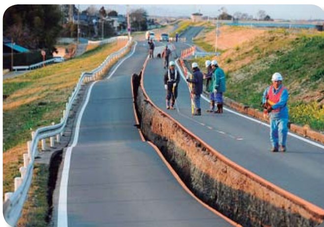
Figura 6 - Consequência da liquefação do solo ocorrida sob uma estrada em Saitama, Japão, por ocasião do terremoto de 11 de março de 2011.
