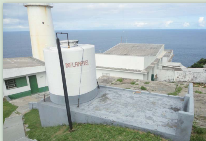
Figura 8 - Tanque primário de recebimento e armazenamento do óleo diesel do Farol de Cabo Frio.
