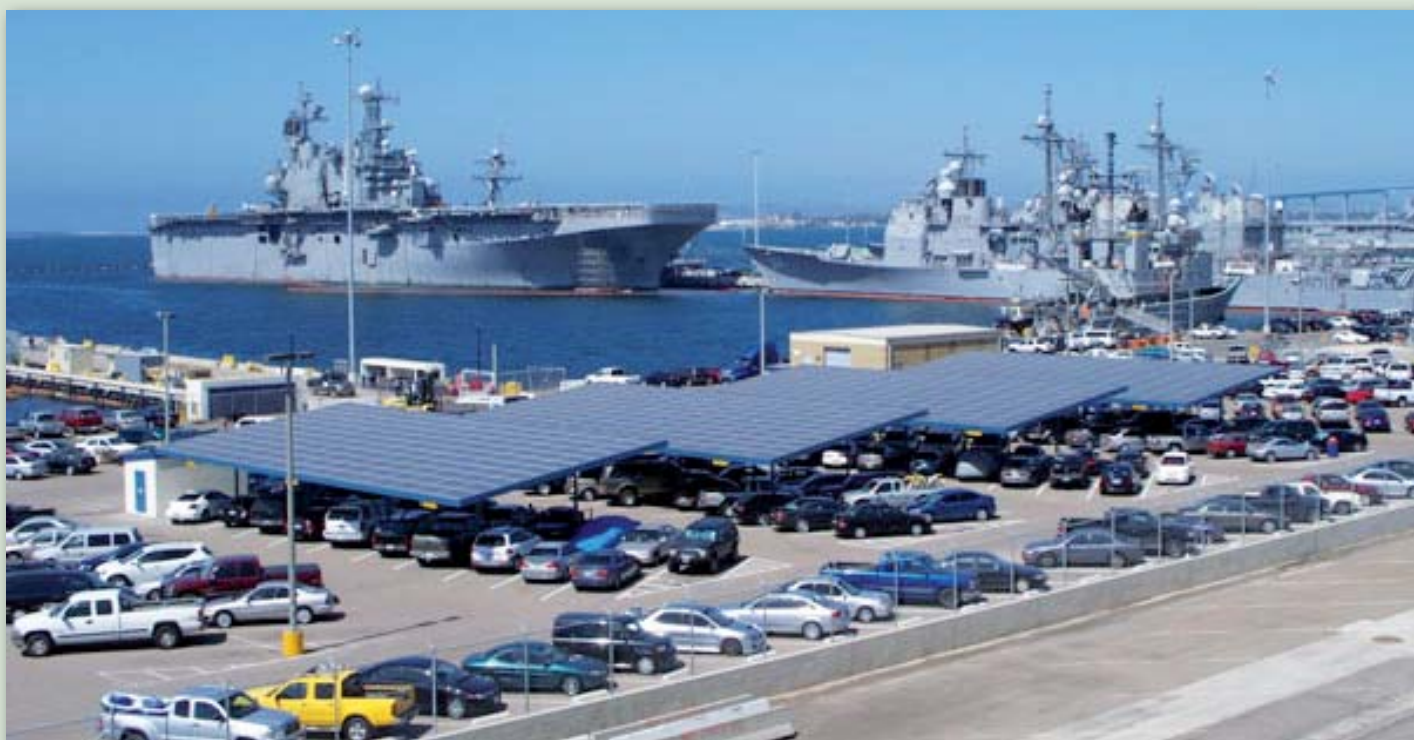
Figura 2 – Sistema de geração solar fotovoltaico instalado na Base Naval de San Diego, Califórnia (Fonte: US Navy , 2010).
