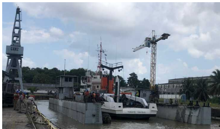
A Base Naval de Val de Cães (BNVC) realizou a desdocagem do Navio-Balizador “Tenente Castelo”, concluindo uma etapa importante de seu Período de Manutenção Geral (PMG), com a realização de reparos estruturais nas obras vivas, nos tanques de aguada e de combustível, troca de ânodos de sacrifício do sistema de proteção catódica, além do alinhamento dos eixos propulsores do navio
